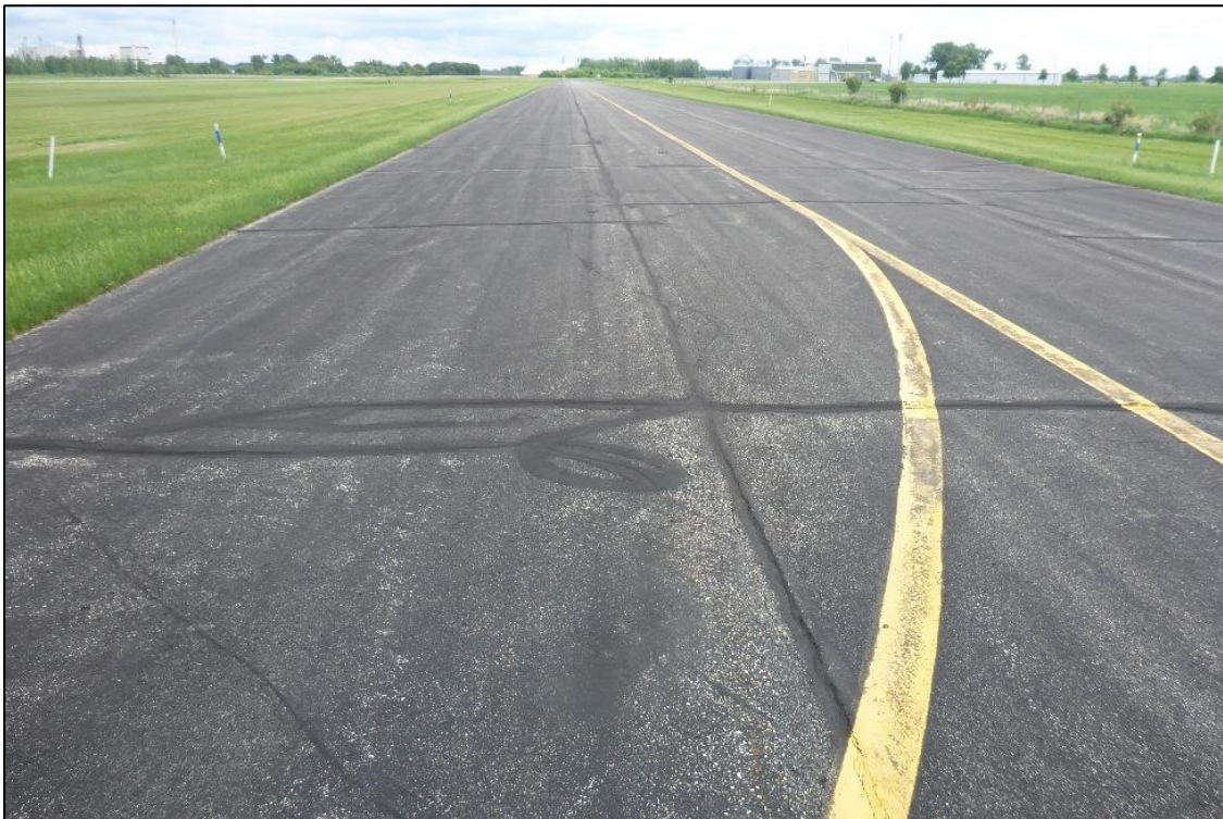
BBB PTA 001 (PCI = 72)
